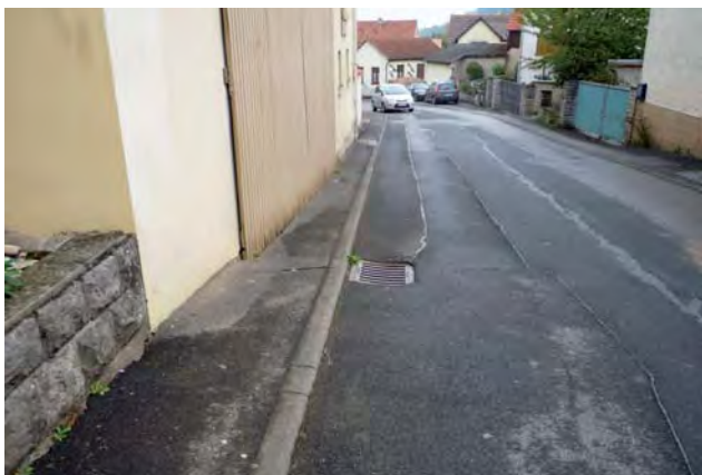
schmaler Gehweg mit baulichen Mängeln
